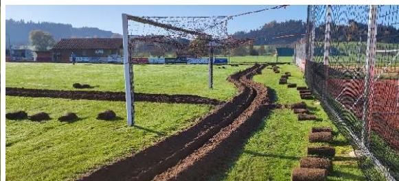
Bewässerungsanlage für beide Spielfelder, mit großer Eigenleistung geschaffen
